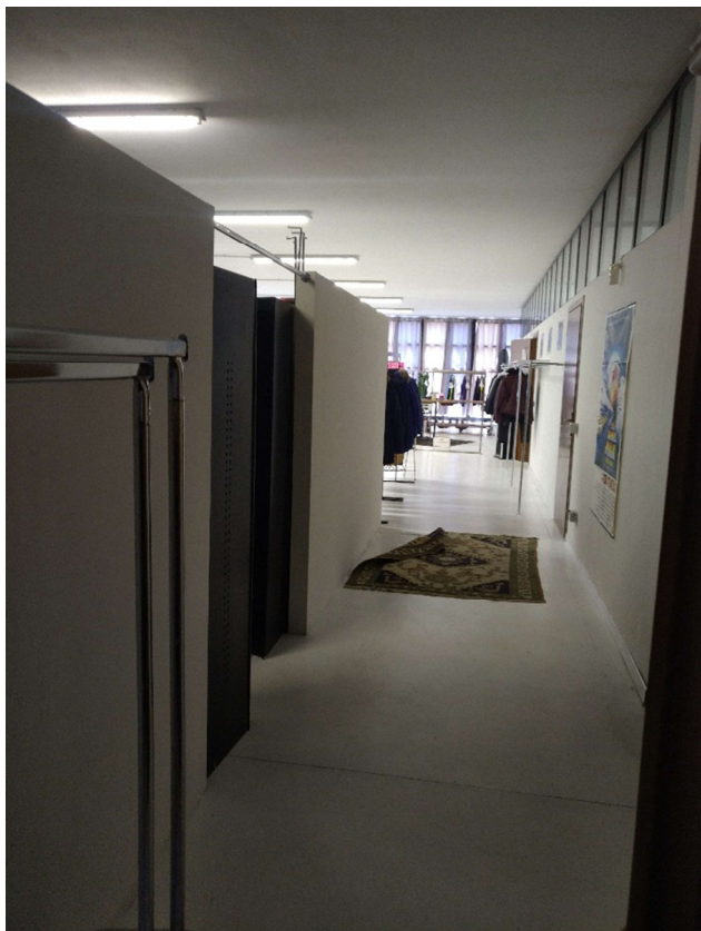
Vista del magazzino e delle pareti difformi
