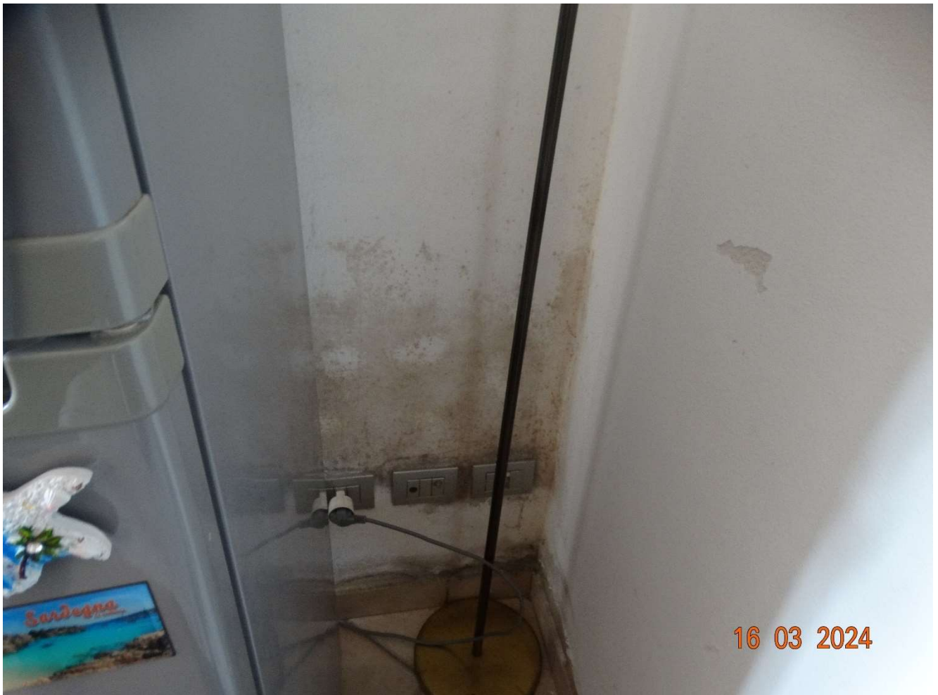
Foto n. 4 – Diffusa presenza di umidità nei muri.
