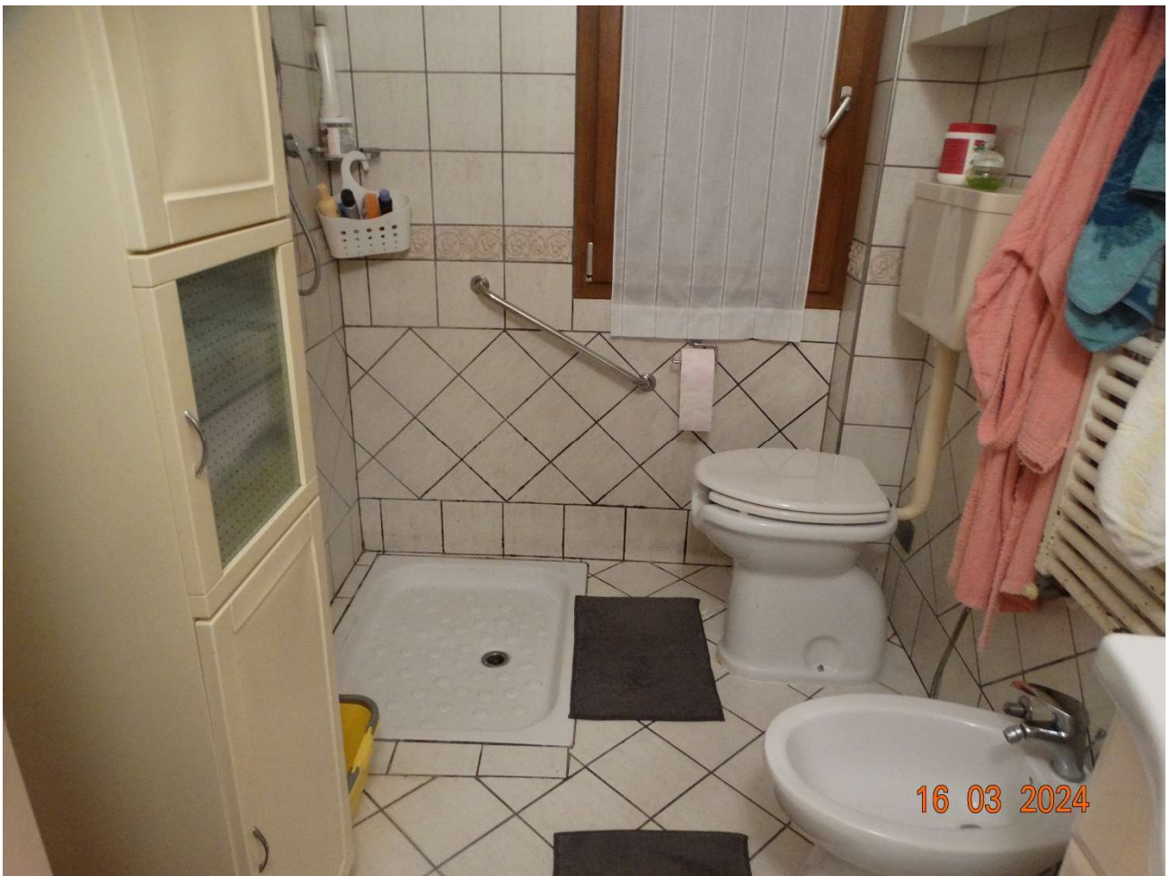
Foto n. 5 – Bagno finestrato con doccia e diffusa presenza di umidità.
