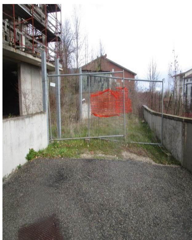
Figura 6: Viabilità incompleta e comune ai beni, sia pignorati in procedura, che isolati dagli stessi provvedimenti.
