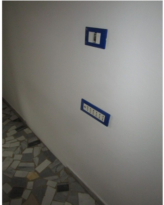
Figura 12: Tipologia di frutti elettrici ad incasso, in sostituzione di quelli originari; è visibile il pavimento primigenio.
