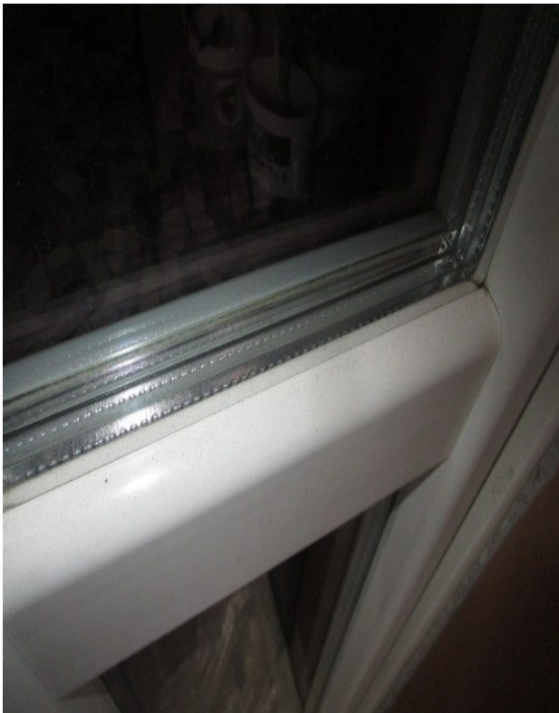
Figura 11: Tipologia d'infissi in p.v.c., con vetrocamera, in sostituzione di quelli originari, dell'epoca di costruzione (1960).
