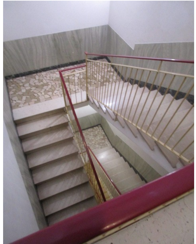
Figura 4: Pianerottolo di sbarco, del terzo piano del palazzo, oltre alla quota rialzata.
