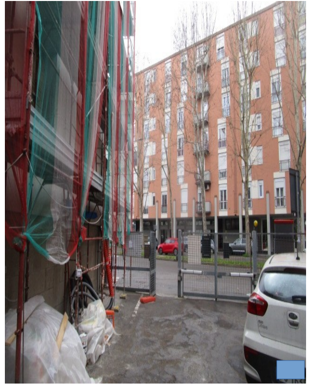
Figura 2: Accessi carrabile e pedonale, a raso della via San Donato, nell'angusto cortile, con scarsità di parcheggi, per auto dei condomini.
