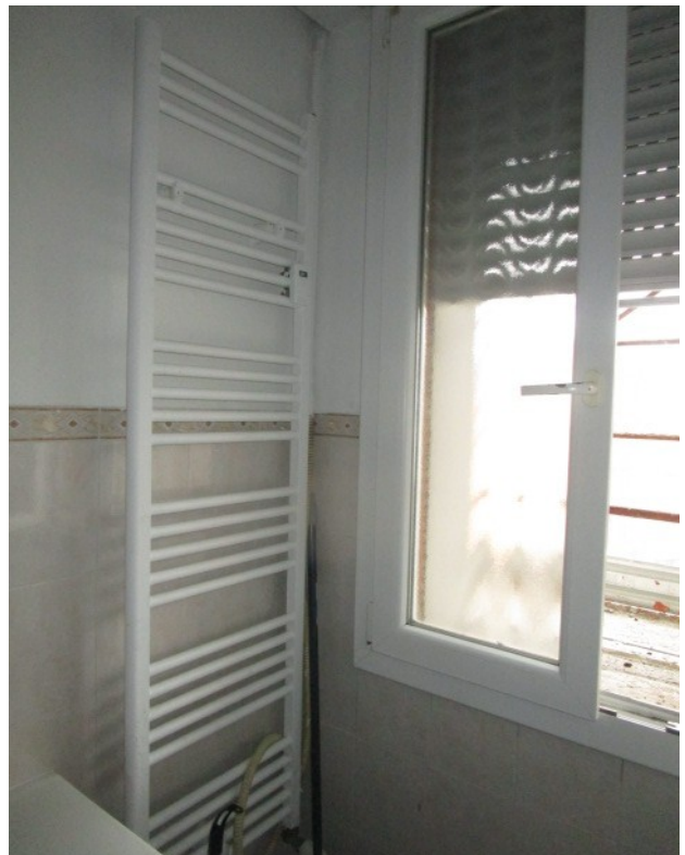
Figura 16: Radiatore in acciaio, interno al bagno finestrato.
