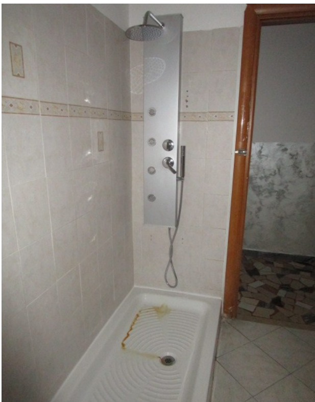
Figura 15: Doccia interna al gabinetto.
