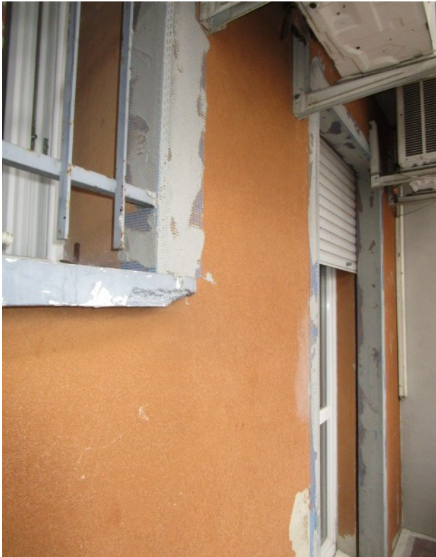
Figura 13: Macchine per la climatizzazione, installate nel terrazzo, con particolare della finestra del cucinotto.
