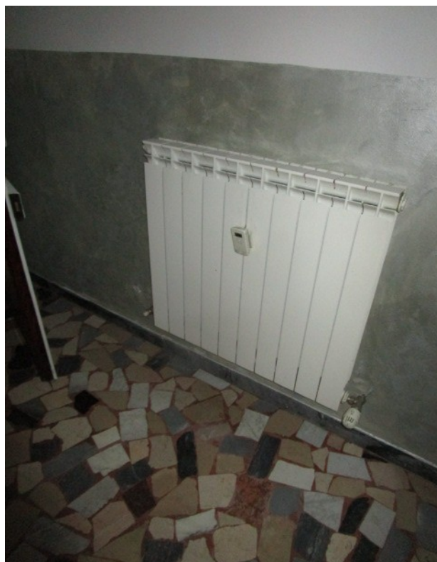
Figura 6: Tipologia di massa radiante, collega-ta al rete del riscaldamento condominiale ed al sistema di contabilizzazione dei consumi.
